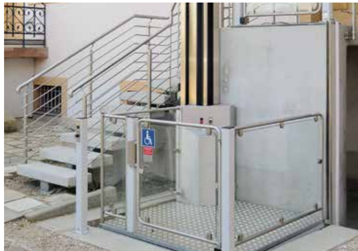
Plattformlift/Hebebühne zur Eingangstür
